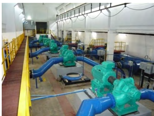
Uzina de apă nr.2- Sala pompelor (foto 2)
