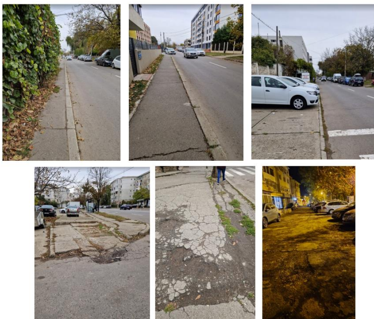
Fig.17. Trotuare în stare rea
